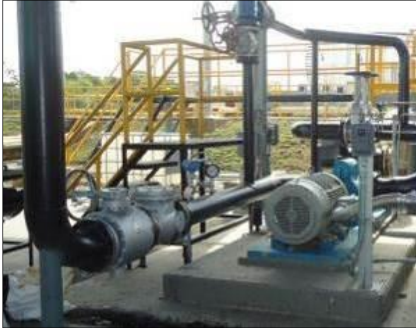
Figura 3. Bombas de Distribución de Diluyente
