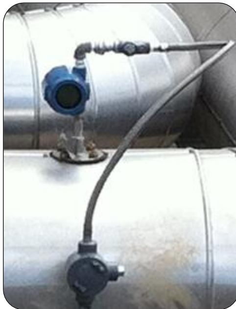
Figura 9. Transmisor de Temperatura
