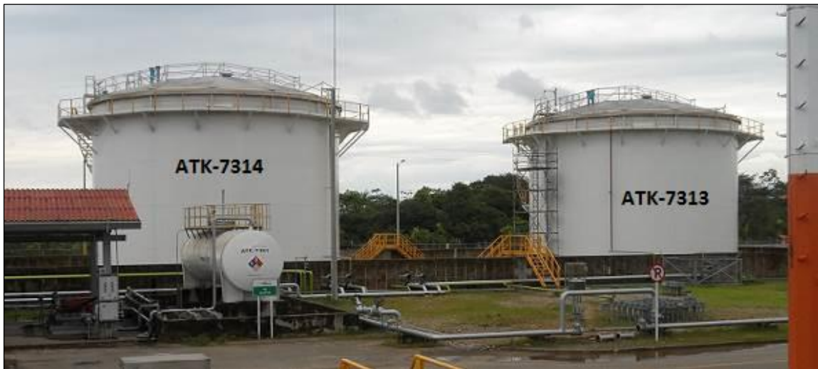
Figura 2. Tanques de almacenamiento de Nafta
